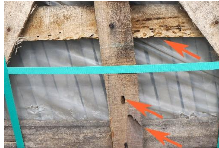
Bohrlöcher/Fraßgänge sind erlaubt, daraus dürfen aber keine Bohrspäne austreten (Bild: A10)
